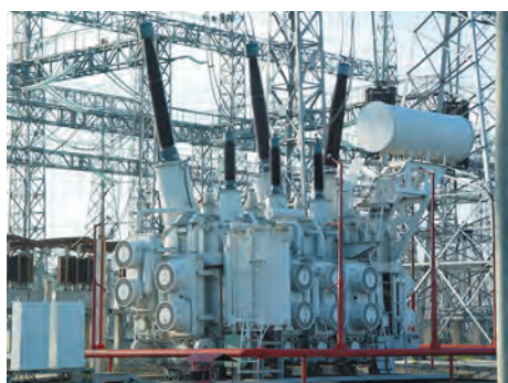
Электрические сети Электростанции, подстанции, линии электропередач
